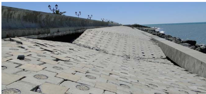
Рис. 8. Деформация откоса берегозащитного сооружения. Апрель 2017 г.
